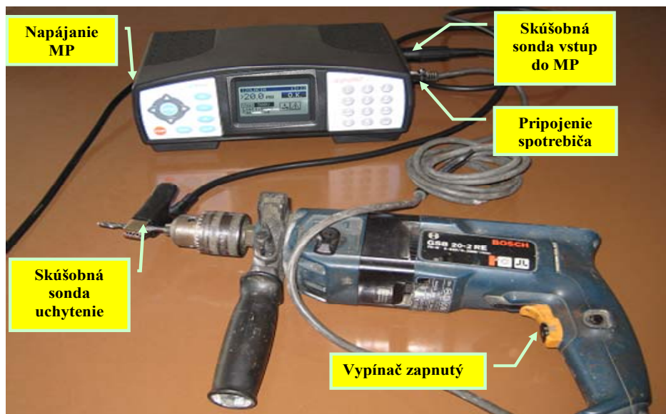
Obr. 7 Príklad merania izolačného odporu R_{IZ} elektrického ručného náradia triedy ochrany II meracím prístrojom AlphaPAT MI 2142 fy. METREL
